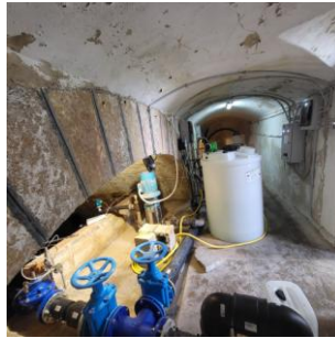
Il nuovo sistema di clorazione serbatoio 'Pipitone'
